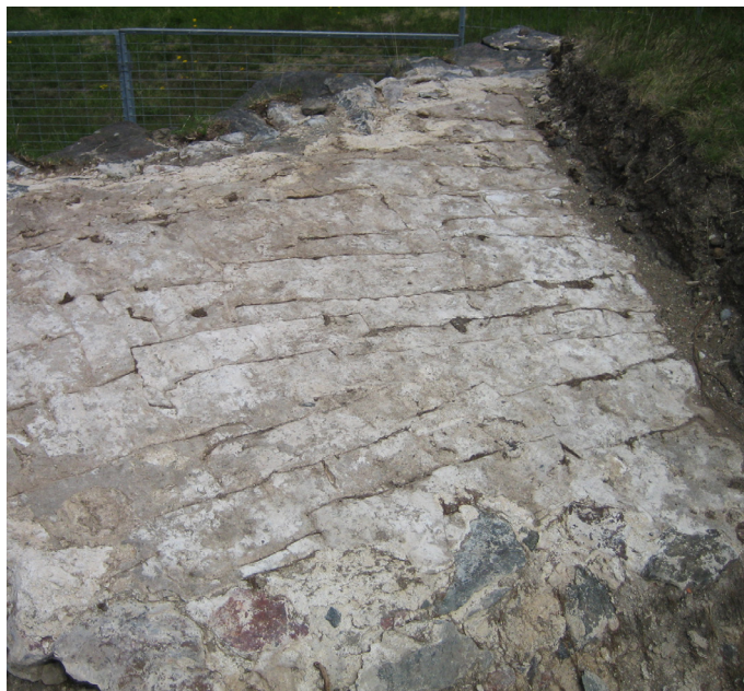
Bastioni Carpelanin rintamuurin yläpinnan vanhaan laastiin on painautunut vanhan tuohieristyksen jäljet. Kuva: Suomenlinna A5, Bastioni Carpelan. Kaj Holmberg / 6.6.2006
