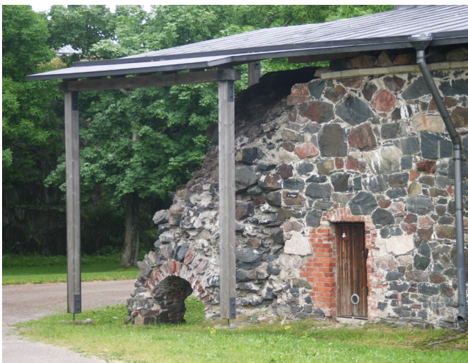
Bastioni Hårlemanin raunioportin suojakatos rakennettiin vuosina 1998–1999 (suun. arkkitehti Petri Mikonsaari). Raunio- muurauksen restauroi Tauno Satolainen. Muurin yläosa on osittain sään armoilla. Veden puutteessa katoksen alla oleva kaunis, kiviä suojannut kasvillisuus valitettavasti kuoli. Usein kun jotain saavutetaan, menetetään jotain toista. Siksi restaurointi on jatkuvaa vaihtoehtojen punnintaa. Kuva: Suomenlinna B31, Bastioni Hårleman. 9.7.2009 / Petri Mikonsaari
