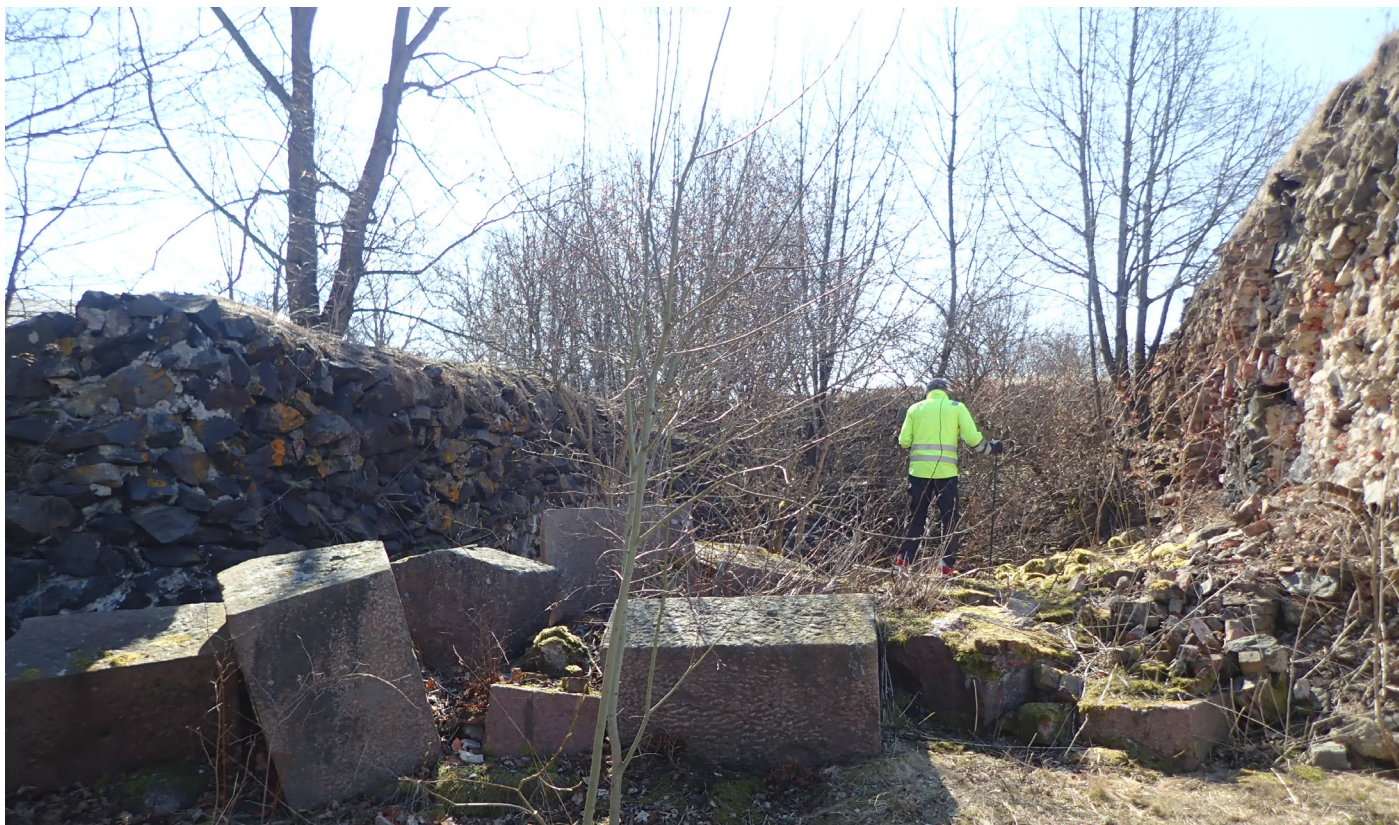
Bastioni Hamiltoniin suunniteltuja sisätiloja ei koskaan toteutettu, mutta niihin liittyvä ulkomuurin sisäpuolinen tiilireveteeraus muurattiin. Osittain maataytteiset puolustusmuurit ovat nykyisin vailla vesieristystä ja varsinkin tiilirakenteiden raunioituminen on aktiivista. Bastionin pohjoispuolella olevat hakatut lohkaaret ovat peräisin 1917 rakennetusta ulkoaltaan suuaukosta. Allasta syvennettiin 1930-luvulla, portti uusittiin ja sen seurauksena kivet nostettiin bastioni ja kavaljeeri Hamiltonin vaikutuspiiriin. Kivet lisäävät rauniotunnelmaa. Kuva: Suomenlinna B21, bastioni Hamiltonin raunio-osa ja kuntokartoitusta suorittava rkm Pentti Koponen. 21.4.2021 / Tuija Lind
