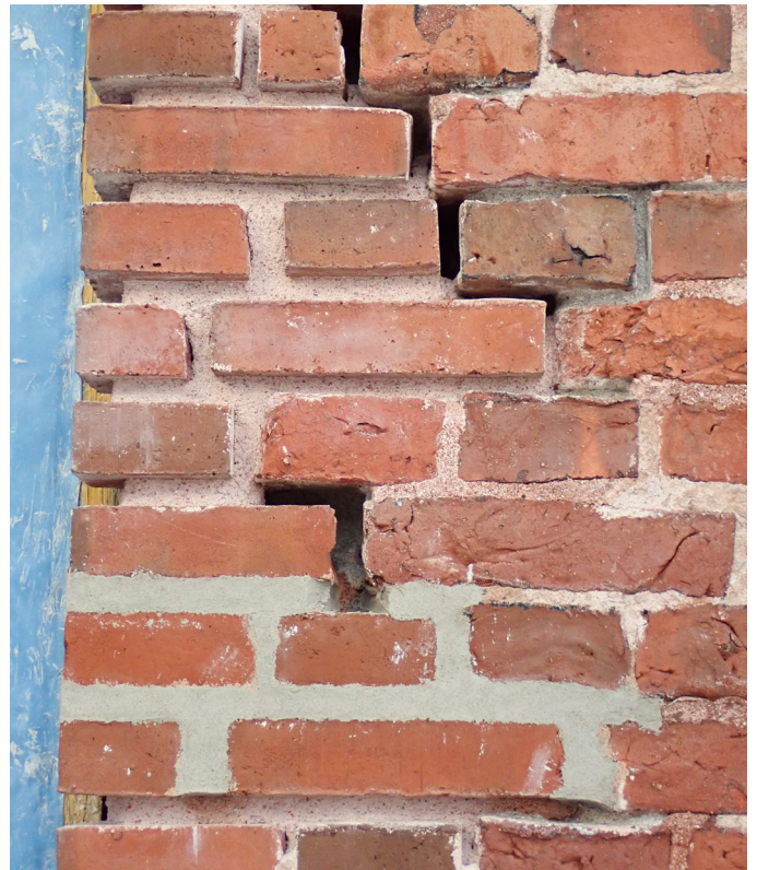
Tenalji von Fersenin leipomon ikkunapielet olivat niin rapautuneet, että ne muurattiin 1990-luvulla uudestaan Yliveskan ruukintilillä. Laastin runkoaineen osana käytettiin tiilimurskaa. Tiilimurskan sitoma kosteus teki laastista ensin lujaa, kunnes 2010-luvulla huomattiin, että kosteus aiheutti myös pakkasvaurioita. Talvina 2016–2021 ikkunapielet korjat- tiin yksitellen talviteltassa. Rapautuneet saumat avattiin ja todettiin, että muurin sisällä on tyhjää tilaa. Onkalot täytettiin tiilenkappaleilla ja laastilla ja saumat uusittiin. Koska ruukintileet ovat matalia, tuli sau- moista leveitä. Kuva: Suomenlinna B17c, tenalji von Fersenin leipomon eteläjulkisivu. 2.12.2020 / Tuija Lind
