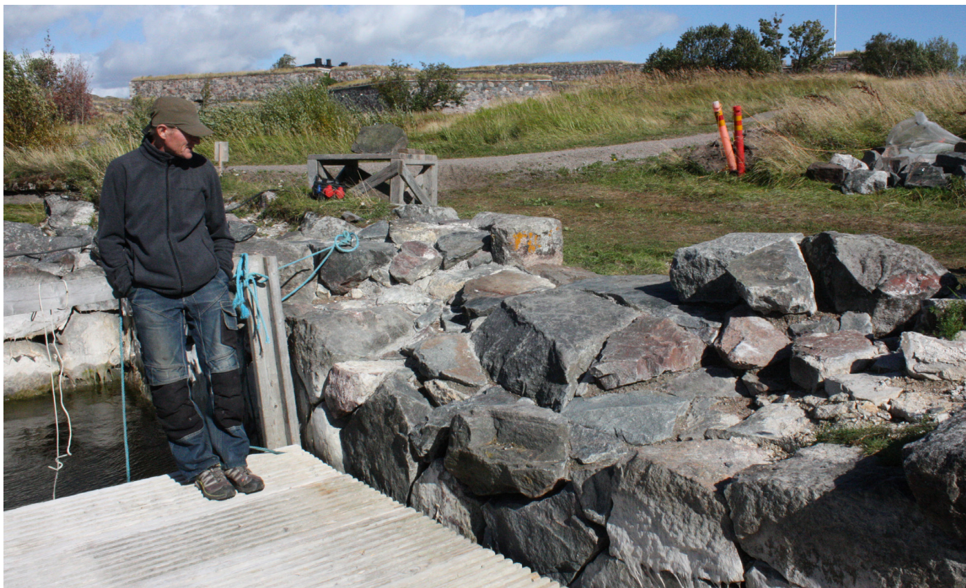
Kustaanmiekalla sijaitsevan makeavesialtaan seinämät olivat aikojen saatossa muuttuneet kylmämuureiksi. Ne myös korjattiin ilman laastia, paitsi altaan yläreuna, jossa kivet kiinnitettiin Korrobetoni-merkkisellä sementtilaastilla. Muurin päällä kävellään ja on tärkeää, etteivät kivet putoa syvään altaaseen, josta niitä on työlästä nostaa ylös. Valokuvassa vankilan työnjohtaja, rkm Pentti Koponen. Kuva: Suomenlinna, Kustaanmiekan vesiallas. Kesä 2012 / Tuija Lind
