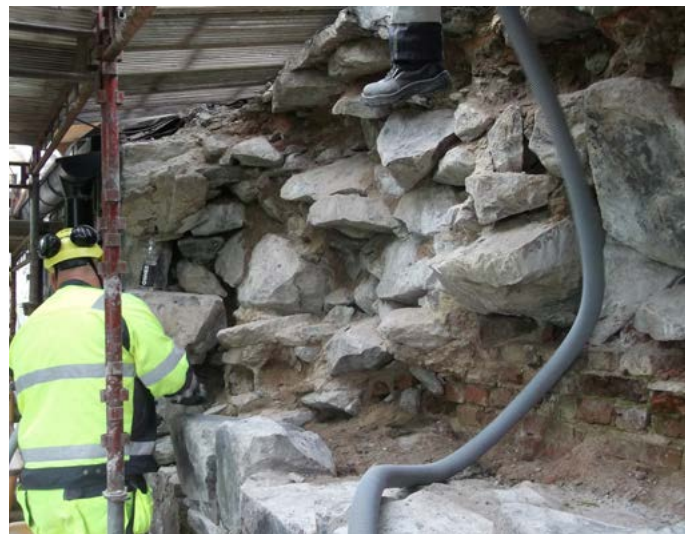
Vesikaton korjaamisen yhteydessä huomattiin, että muurin yläreuna oli sortumassa ja muuria jouduttiin purkamaan. Kuva: Suomenlinna B31, Bastioni Härleman. 3.7.2017 / Tuija Lind
