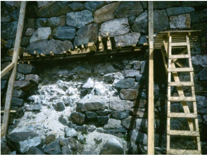
Kustaanmiekkan rantavarustuksessa oli paikallisia sortumia. Sortumien tukemiseen käytettiin paljon aikaa, jotta ehjää muuria voitaisiin säilyttää mahdollisimman paljon. Sortuneesta muuriin osuudesta kannattaa tehdä rakenteellisesti parempi kuin alkuperäinen, esim. lisäämällä pitkien kivien määrää. 1990-luvun alussa ei työturvallisuuteen kiinnitetty yhtä paljon huomiota kuin tänä päivänä. Nykyisin tilapäinenkin tikkailta työskentely olisi kiellettyä. Kuva Suomenlinna A13, Rantavarustus. Kesä 1992 / Tuija Lind
