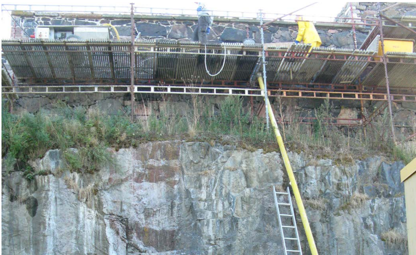
Taidokkaasti korjatun ja oikea-aikaisesti pestyn muurin pesuvesi oli päässyt valumaan kallioleikkaukseen. Muurin pesuvesien hallinta täytyy tehdä suunnitelmallisesti. Kuva: Suomenlinna A7, Bastioni Zander. 18.8.2010 / Tuija Lind
