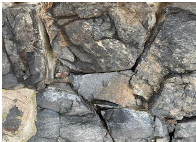
Hyvin puhdistetussa muurissa ei ole irtoainesta kivien välissä. Kuvan muuri on kärsinyt tulipalosta.
