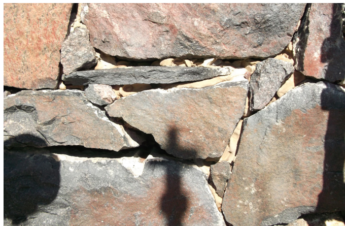
Suomenlinnan muureissa on eri-ikäisiä ja erityyppisiä korjauksia. Kuvan Parmu-laasti on pumpattu 1970-luvun alussa. Pumpattava sementtilaasti liimaa kivet hyvin paikoilleen, mutta sitä käytettiin usein ainoastaan pinnassa. Laastia ei pumpattu syvälle muuriin, eikä kivien välejä pumpattu täyteen. Jos kivien takana oleva laasti on rapautunut ja siihen pääsee vettä, aiheutuu jäätymisen myötä sortumavaara. Kuva: Suomenlinna B46, Bastioni Kunnia. 17.6.2015 / Tuija Lind
