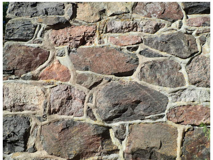
Osa bastioni Höpkenin muureista on saumattu sementtilaastilla todennäköisesti 1920-luvulla. Koristeelliset jälkisaumat ovat Suomenlinnassa harvinaisuus. Kuva: Suomenlinna B6, Bastioni Höpken. 21.7.2021 / Tuija Lind
