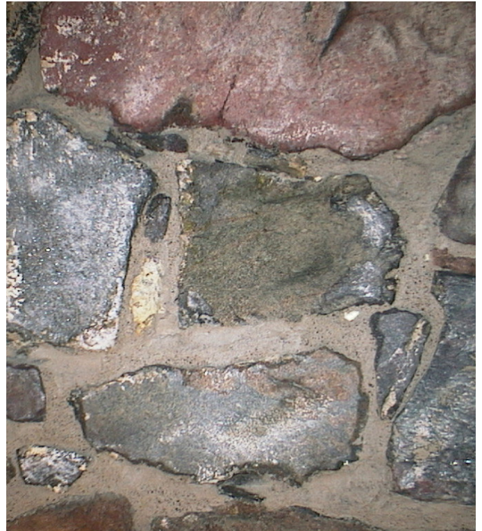
Huono esimerkki syvätytetyistä muurista: kiilakiviä on liian vähän ja muurin pesu on tehty huolimattomasti. Tämän kaltainen korjaustyön jälki on lyhytikäinen. Laasti rapautuu helposti, jos ja kun se jäätyy läpimärkänä. Muuri on myös ruman näköinen.
